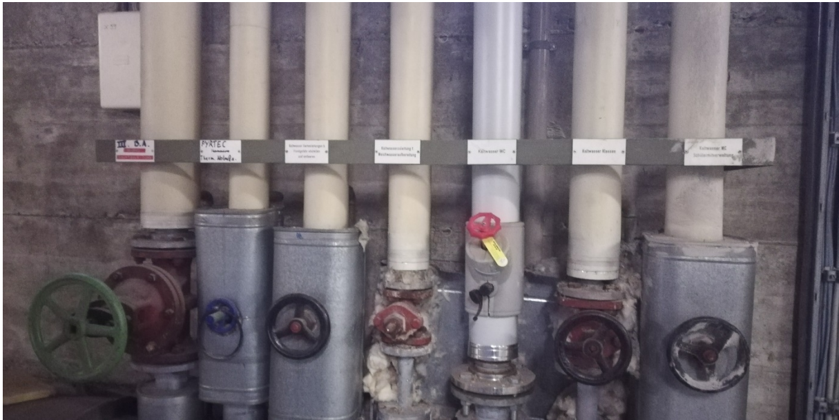
Hauptwasserverteilung mit defekten Ventil
