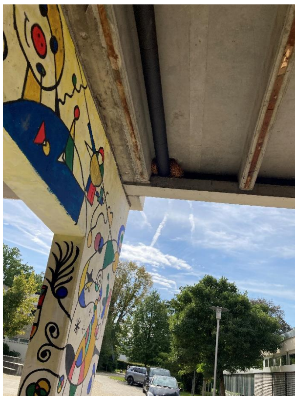
Foto: Rippendecke Eingangsbereich mit geschädigter Stütze
