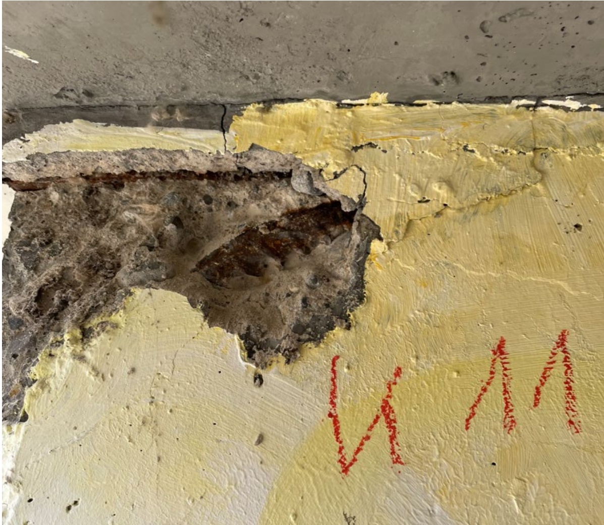
Bild 2: Beton und Stahlkorrosion am Stützenkopf an Stütze 2 bei Probestelle 11
