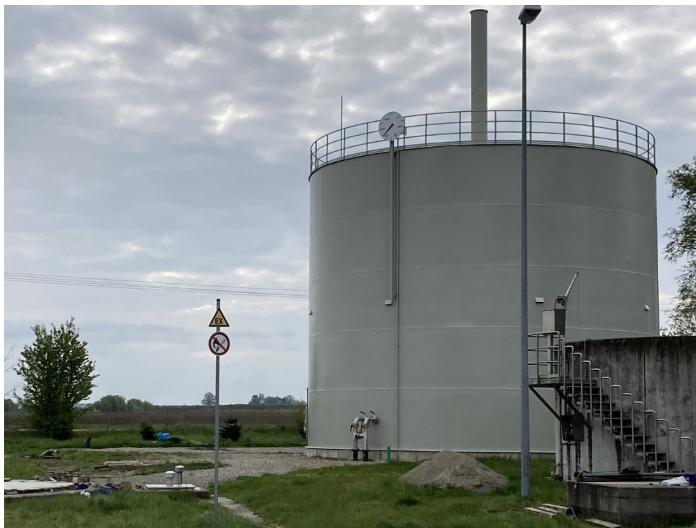
Gasbehälter während Probebetrieb April 2024
