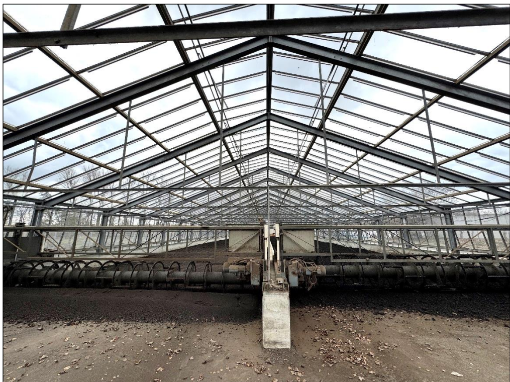
Gewächshaus zur Trocknung von Klärschlamm Innenansicht, 17.03.2025
