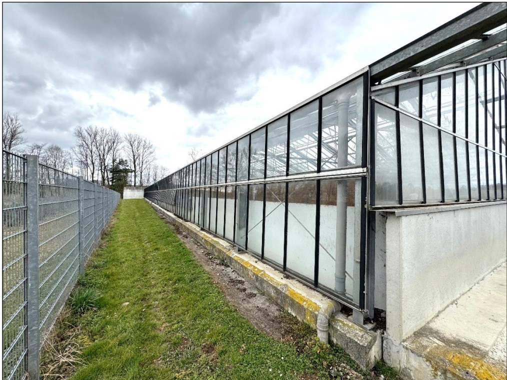
Gewächshaus zur Trocknung von Klärschlamm Rückseite, 17.03.2025
