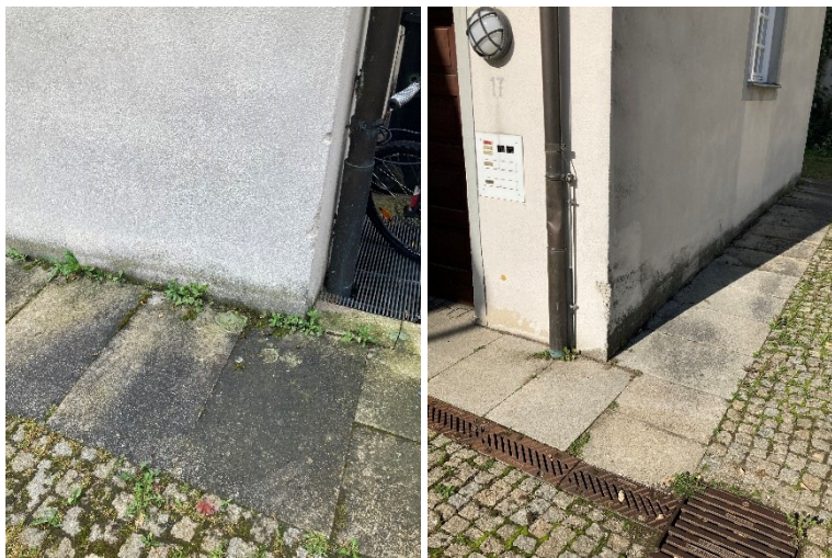
Bild: Schädigung des Sockelbereichs durch Spritzwasser
