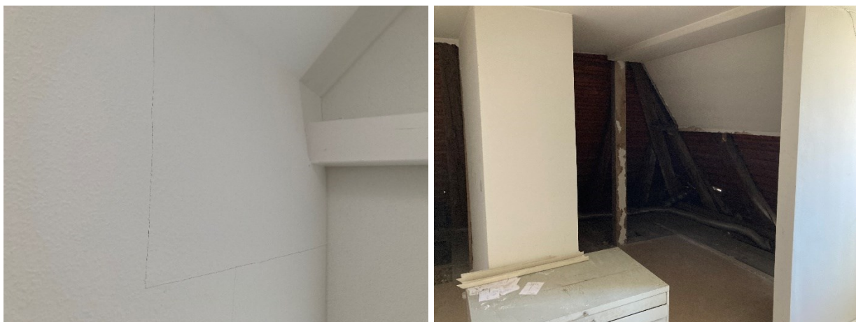
Bild: Öffnungen von Wänden mit Rissen und Aufnahme in die Schadenskartierung
