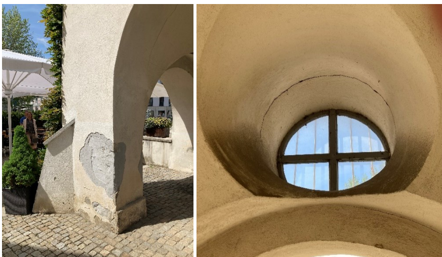
Bild: Schädigungen im Laubengang
