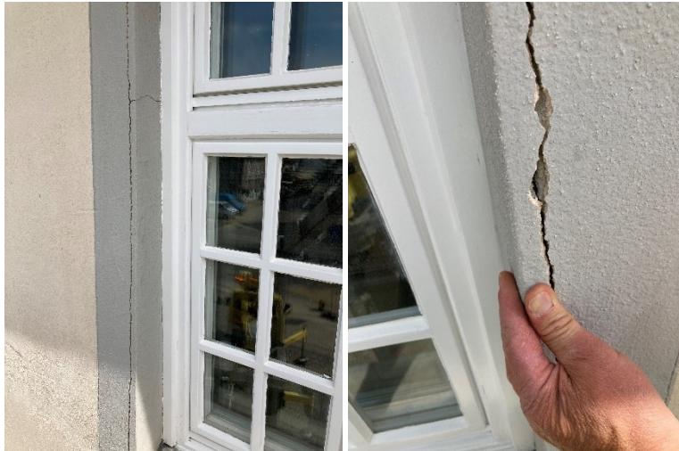
Bild: Defekter Putz an den Fensterlaibungen zum Marktplatz
