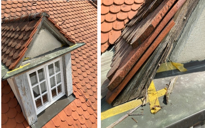
Bild: Holzschädigung der Gauben im Dachgeschoss
