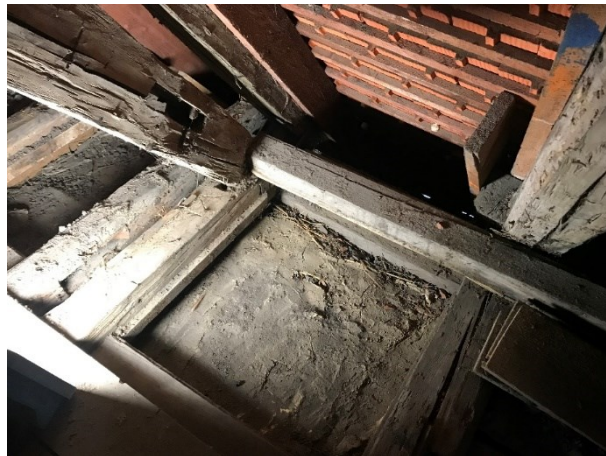
Bild: Fehlende Aussteifung des Dachverbands im gesamten Dachstuhl
